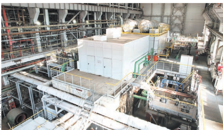
По итогам 2024 года ВТЭЦ-2 выработала более 2,6 млрд кВт/ч электроэнергии.
